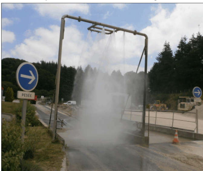
Laveur de roues et rampe d'aspersion en sortie de site
